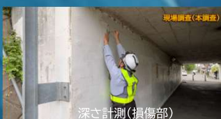
深さ計測(損傷部)
