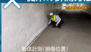
躯体計測(損傷位置)
