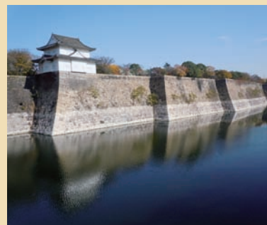
図-3 屏風折れした石垣が連続する南外堀(筆者撮影)
